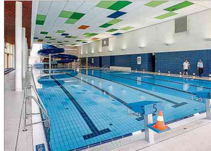
14 Millionen Euro hat das Schwimmbad gekostet. Zehn Jahre später muss es für 4,7 Millionen saniert werden. (FOTO: GUY JALLAY)
